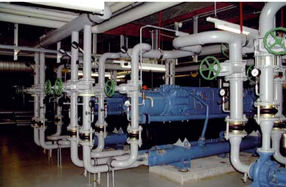
Cofely sorgt für den reibungslosen Betrieb der Kälteanlagen.
