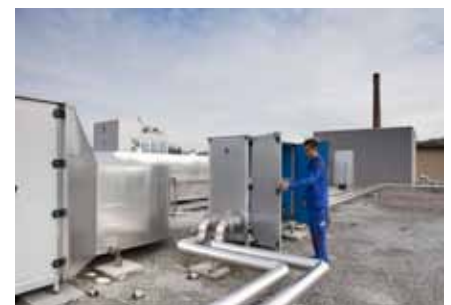
Abluftmonobloc auf dem Dach des Laborgebäudes 325 von Siegfried Ltd.
