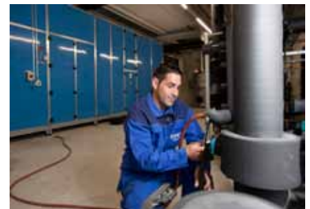
Service-Techniker von Cofely.
