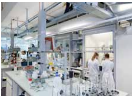
Gebäudetechnik-Lösungen im Labor.
