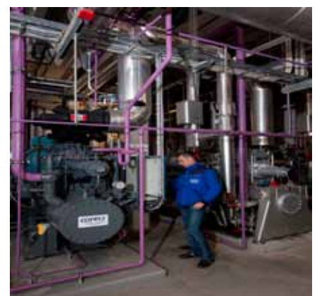
Effiziente Kälteerzeugung: die hochmoderne Ammoniak-Kompressionsanlage.
