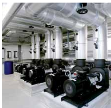
Zuverlässig: Kaltwasserpumpen für die Monoblocs.
