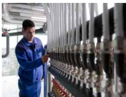
Insgesamt wurden 32 TABS-Verteiler mit durchschnittliche 20 TABS-Kreisen angeschlossen.
