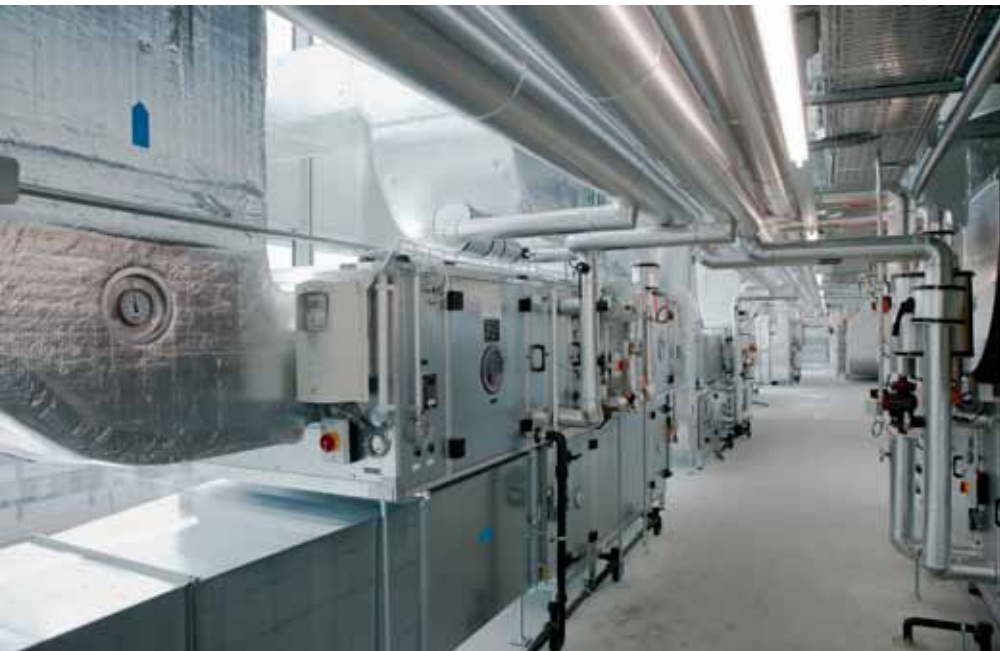
28 Monoblockanlagen und 20 Ventilatoren stellen die Belüftung des Bahnhofs Aarau sicher.
