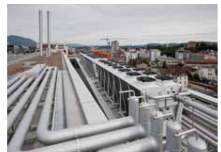
Die Rückkühler wurden auf dem Dach des Bahnhofs Aarau platziert.
