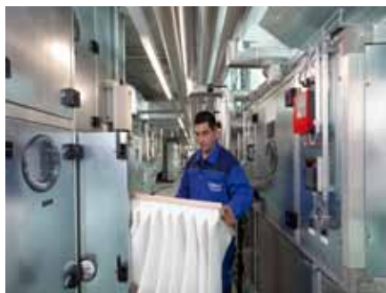
Die Luftfilter werden durch den Servicetechniker von Cofely geprüft.
