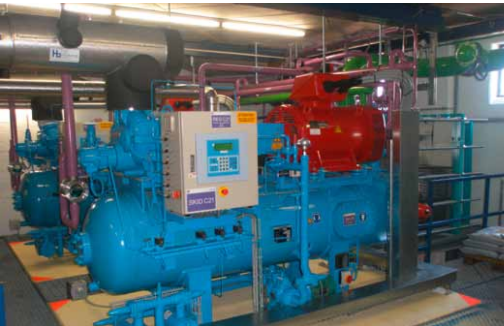
Salle des machines.
