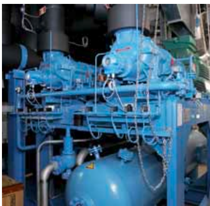
Entfeuchtung durch Kühlung: Zwei Schraubenkompressoren erzeugen 1800 kW Kälteenergie.
