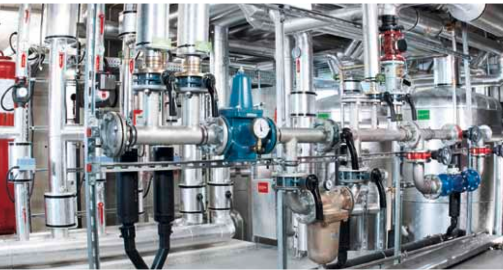
Erfüllt sämtliche Ansprüche: die Sanitärinstallation.
