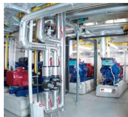
Auch für die Klimakühlung der Halle im Sommer: Kältemaschine mit fünf Kolbenverdichtern.
