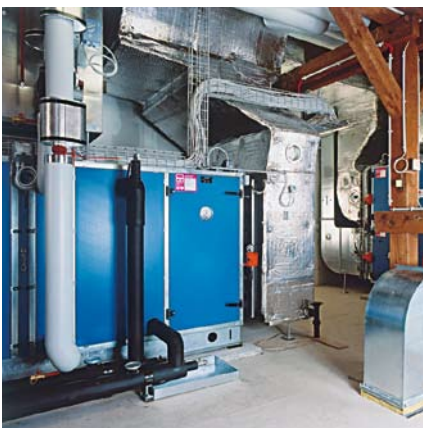
Lüftungsinstallationen für Säle, Theater, Restaurant und Küche im Dachraum.
