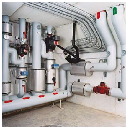
Fernheizungsanschluss und Heizverteiler.
