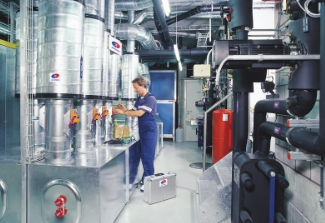
Zuluft-Volumenstromregler mit den Schalldämpfern in der Technikzentrale des Untergeschosses.
