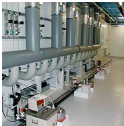
Nassbank-Anschlüsse im Servicebereich
