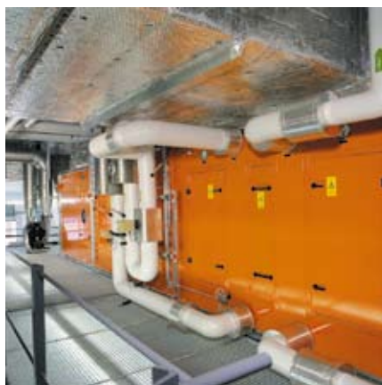
Monobloc, appareil de traitement d'air soufflé à l'entresol près de la salle blanche.
