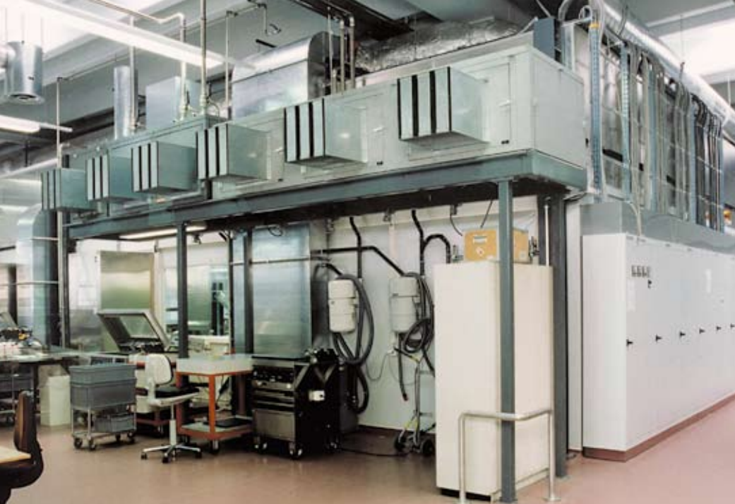
Vue de la cellule de la salle blanche depuis la salle d'expédition, les pompes à vide avec les silencieux se trouvent sur les tréteaux.
