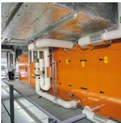
Monobloc, Zuluftaufbereitungsgerät im Zwischenstock über dem Reinraum.
