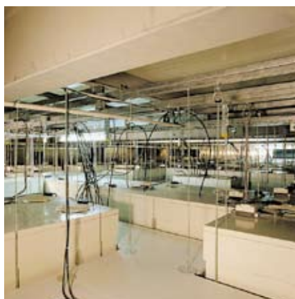
Deckenplenum mit den Zuluftkanälen für den Reinraum und den Filter-Ventilator-Einheiten.
