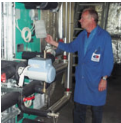
Die technischen Anlagen werden in den grosszügigen Technikräumen in den Untergeschossen überwacht
