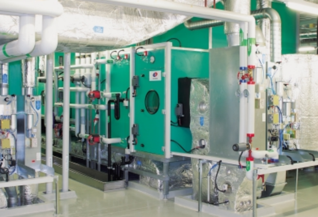
Unité de traitement d'air avec régulation de débit pour air soufflé et deux gaines d'évacuation pour une salle blanche de 4°C.
