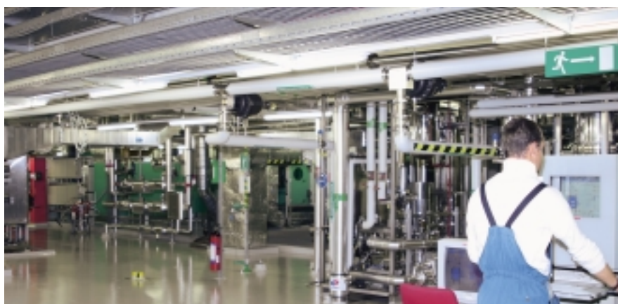
Locaux techniques «Mezzanine» avec des Monoblocs pour le traitement d'air neuf et de circulation dans les salles blanches et des installations pour la production de vapeur blanche.
