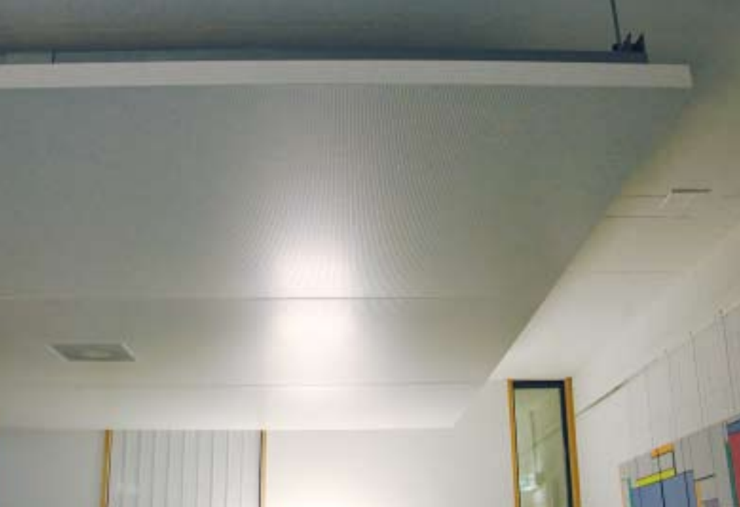
Abgehängte, perforierte Kühldecke, seitlich offen.
