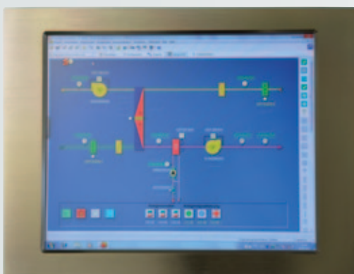
Touchscreen mit Anlagebild.
